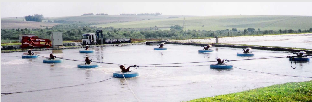
Tanque de aeração com 10un de ABM160 20CV
